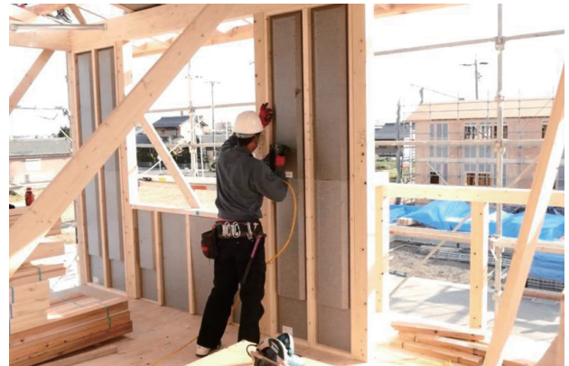
物林が展開するソルツの現場施工の風景。最短1日、長くても2日でフレーミング工事が完了する
